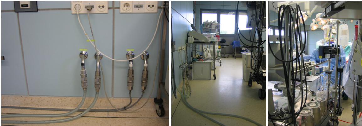
Abbildung 37: Vom Warmwasserkompressor, der auf dem Flur steht, führen unisolierte Schläuche in langen Windungen durch dem 15°C kalten OP zur Herz-Lungen-Maschine.
