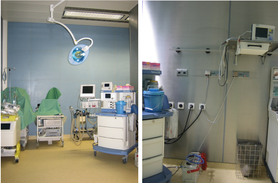
Abbildung 8: Im hinteren Teil des Einleitungsbereichs lagern die Ersatzgeräte der Anästhesie; die Trennwand bietet die Anschlüsse zum Laden der Akkus für Defibrillator und Patientenmonitor
