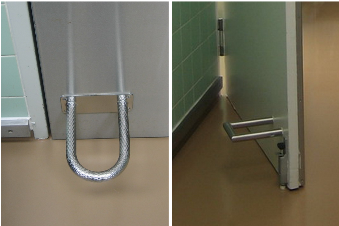
Abbildung 39: Viele der Drehtüren in diesem OP-Bereich verfügen über Fußangeln zum Öffnen der Türen. Einige sind rund (wie z.B. an den Verbindungstüren zwischen Waschräumen und OPs) die anderen sind eckig (wie z.B. an den Verbindungstüren zwischen OPs und ‚Sterilflur‘).
