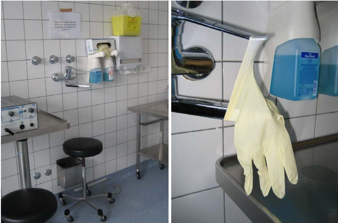
Abbildung 41: Während der Raum für Kinder-OPs genutzt wird, wird die Spüle aus dem Raum geschoben. Der Ablauf (schwarzer Kasten unterhalb des Wasserhahns) ist deshalb entsprechend ausgeführt. Um ein versehentliches Betätigen des Wasserhahns zu verhindern, wird dieser durch einen Gummihandschuh geschlossen gehalten.
