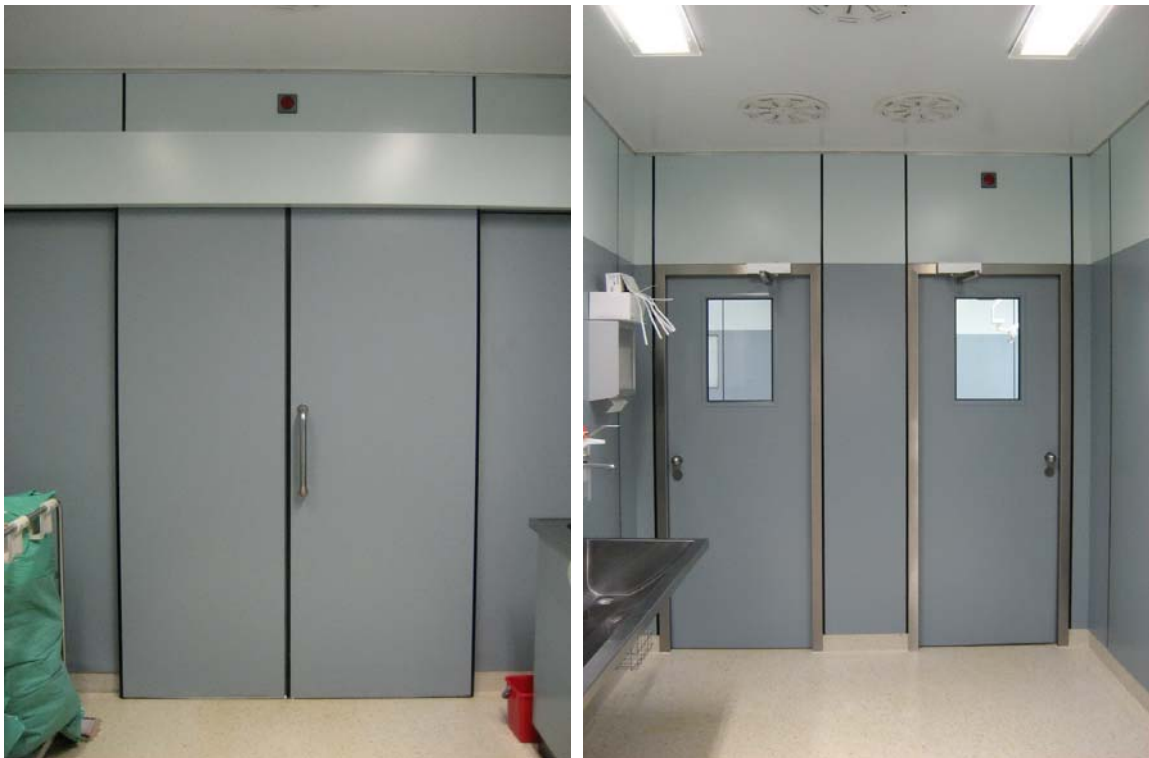
Abbildung 17: Sowohl über der Tür, die vom Einleitungsraum 1 in OP 1 führt, als auch über der Tür, die vom Waschraum in OP 1 führt, befinden sich rote Laserbetrieb-Warnleuchten.
