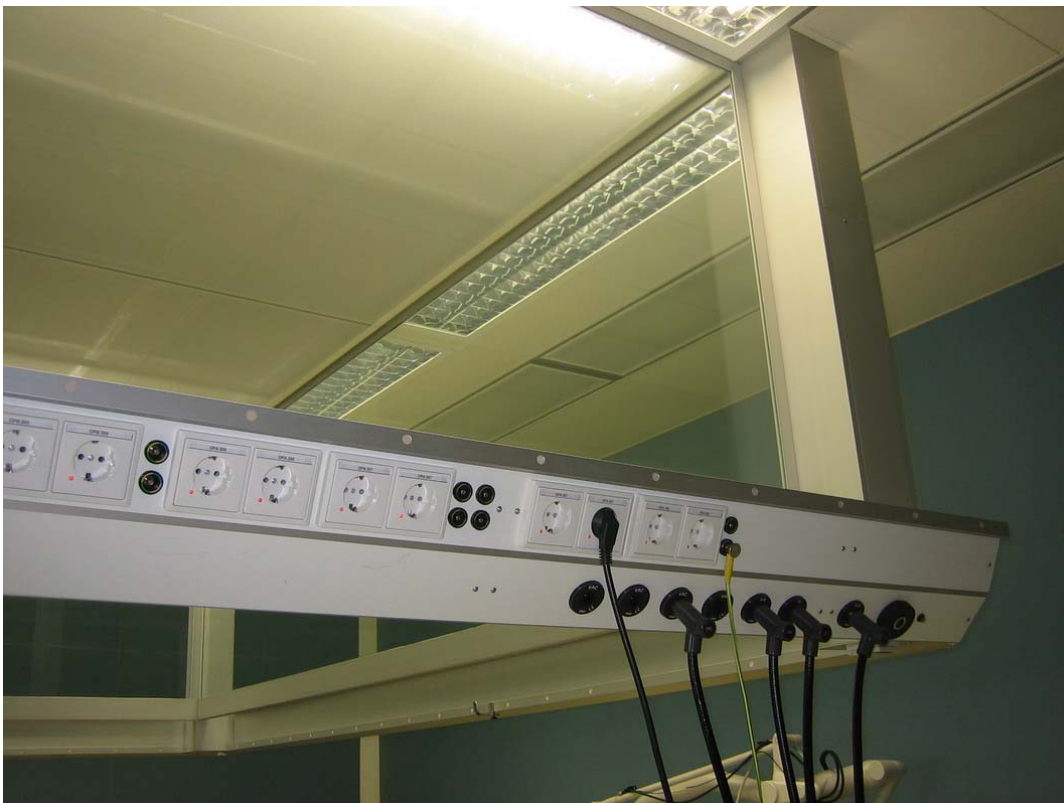
Abbildung 14: Die Schürze der Zuluftdecke reicht bis auf 1,95m herunter. Am unteren Rand der Schürze befinden sich die Elektro- und Gasanschlüsse.
