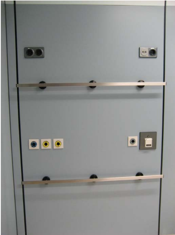
Abbildung 35: Beide Einleitungsräume verfügen über die notwendigen Anschlüsse, allerdings fehlen zusätzliche Narkose- und Monitoringgeräte.
