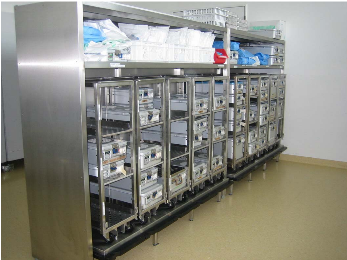
Abbildung 20: Im Lager der Orthopädie befinden sich die Sterilgut-Container in fahrbaren Wagen, die innerhalb eines Regals auf einem 27cm hohen Sockel stehen.
