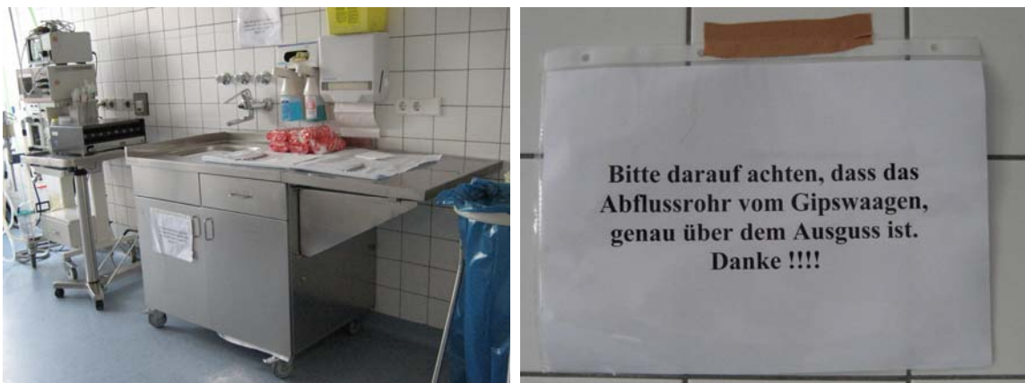
Abbildung 42: Sowohl an der Spüle als auch an der Wand mahnen Schilder, dass das Abflussrohr direkt über dem Ausguss sein muss. Ist dies nicht der Fall, läuft das Abwasser auf den OP-Fußboden.
