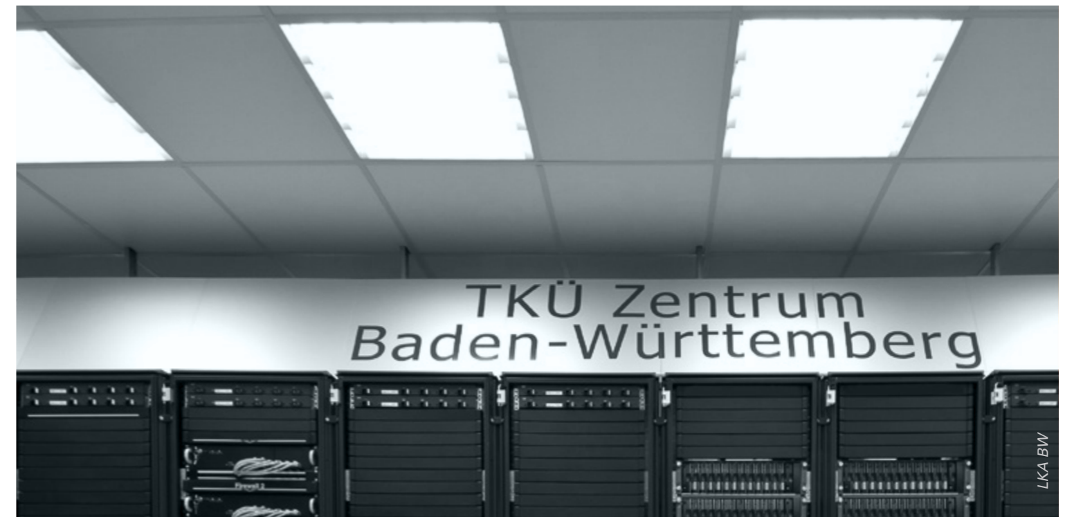
TKÜ-Zentrale des LKA BW
